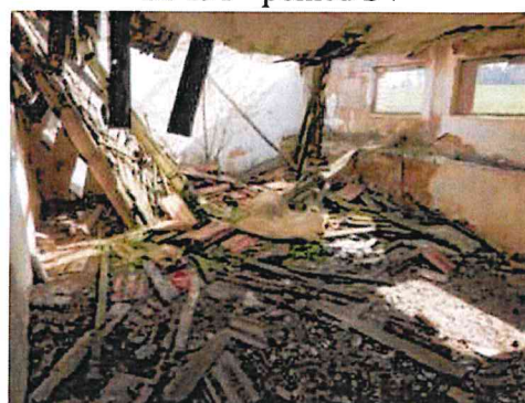
st. 191 - interier-spadlý strop
